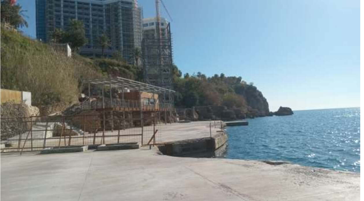
Şekil 2. Antalya'nın Muratpaşa ilçesi Şirinyalı Mahallesi'nde bulunan 5 yıldızlı bir otelin sahilinde inşa edilen asansör.
